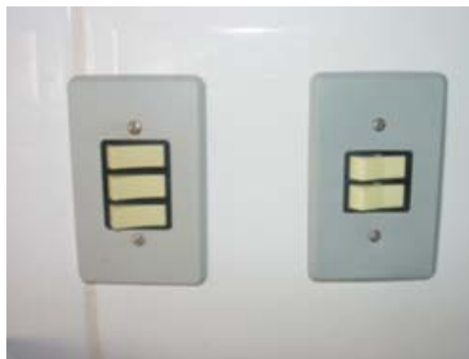
Instalação elétrica embutida
