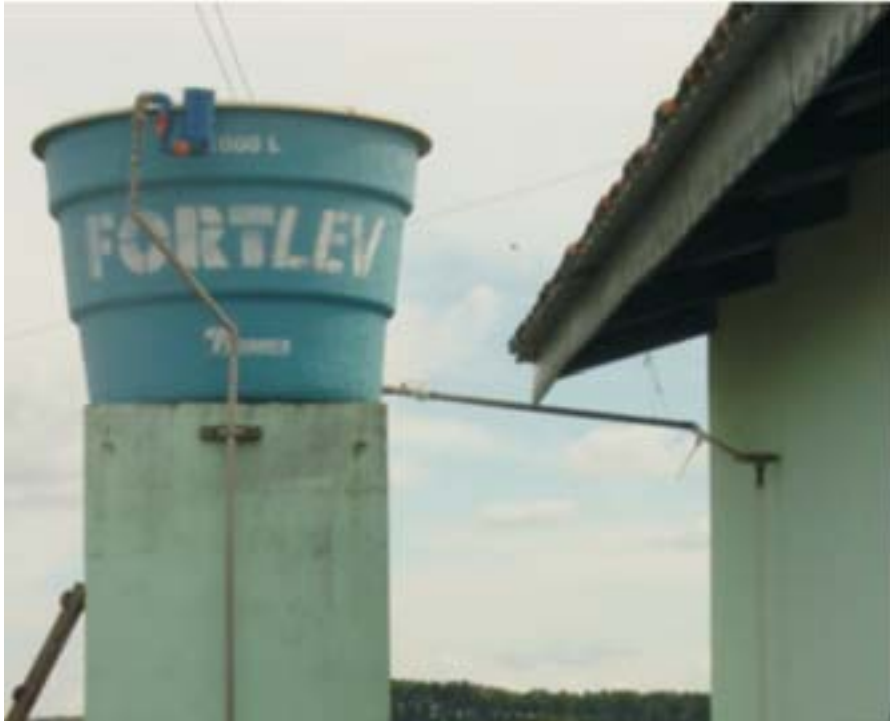
Reservatório de água potável para utilização na queijaria
