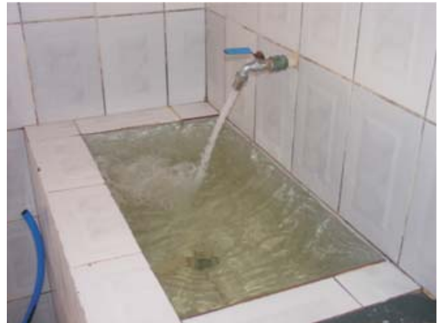
Instalações com água potável e com pressão adequada
