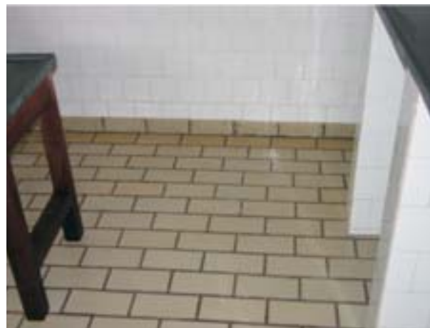
Piso da queijaria: resistente, impermeável e antiderrapante
